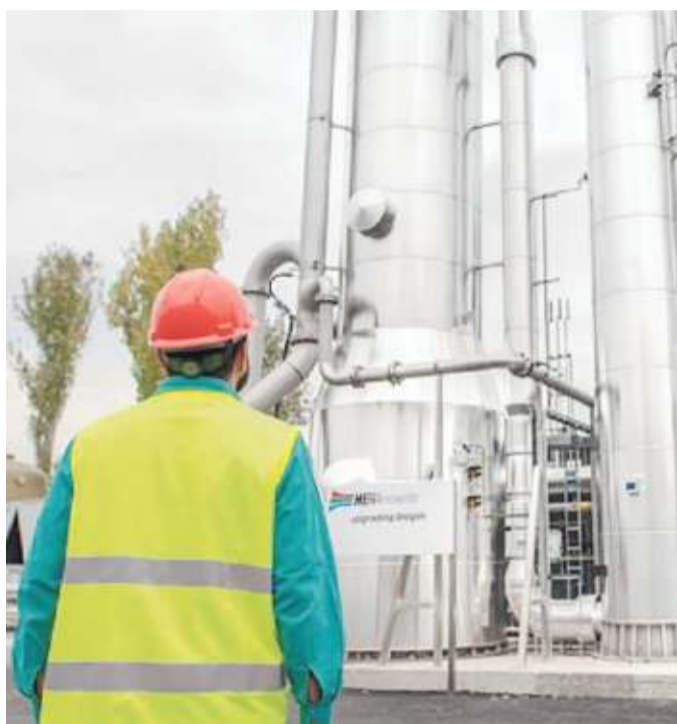
La centrale a biometano di Hera in funzione a Sant'Agata Bolognese
